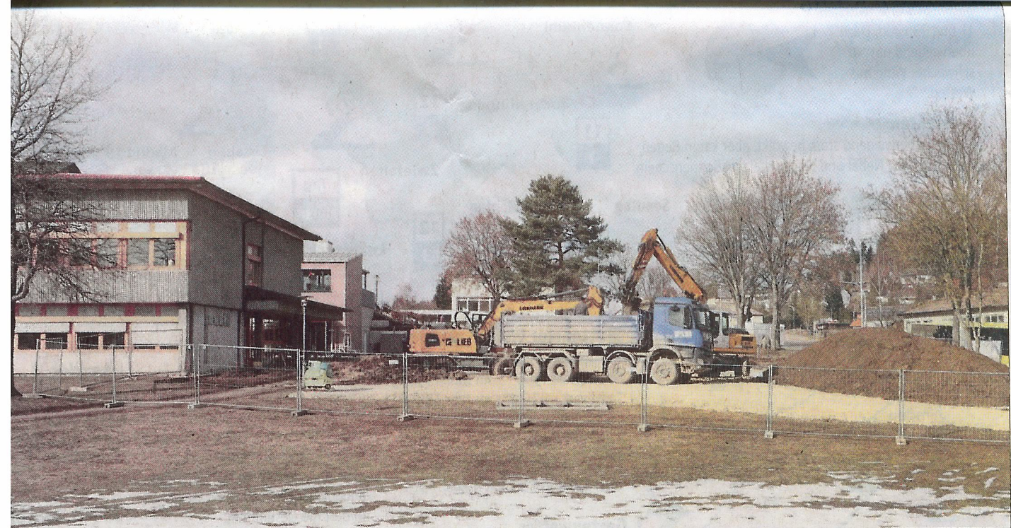
rei Jahre Dauerbaustelle an der Trochtelfinger Werdenbergschule: Im Gemeinderat gibt es die Befürchtung, dass die Kosten des Millionenprojektes aus dem Ruder laufen könnten.
